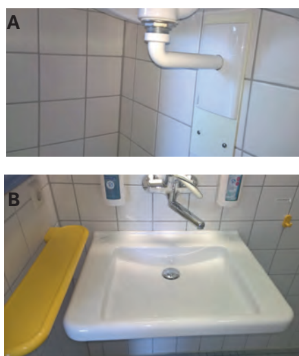
Figure 1 : A : Bonde d'évacuation en forme de L et B : Lavabo plat dans le service de rééducation.
